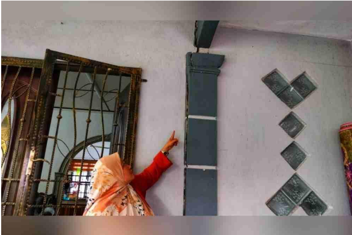
Asniza menunjukkan kesan retakan dalam rumahnya akibat mendapan tersebut.
