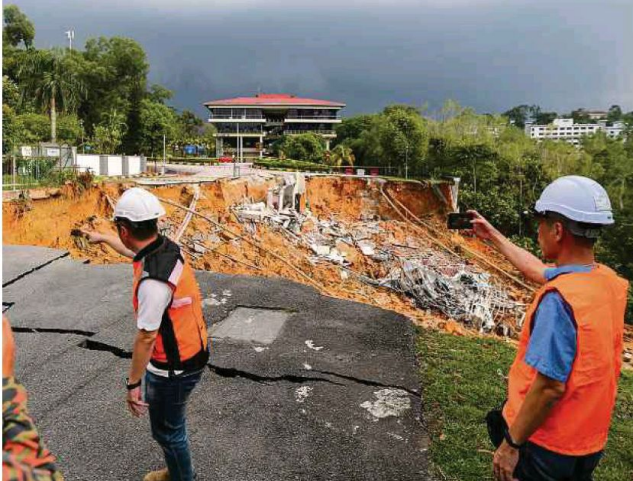
Tanah runtuh di bangunan Akademi Pencegahan Rasuah Malaysia, Jalan Duta dipercayai berpunca daripada paip air pecah.
